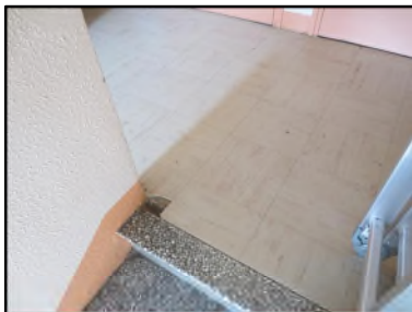
Photo N° 644 ECH-N°1 REVETEMENT DE SOL --PALIER VOLEE ESCALIER +1 Planchers Dalles de sol beige 30x30 avec colle noire
